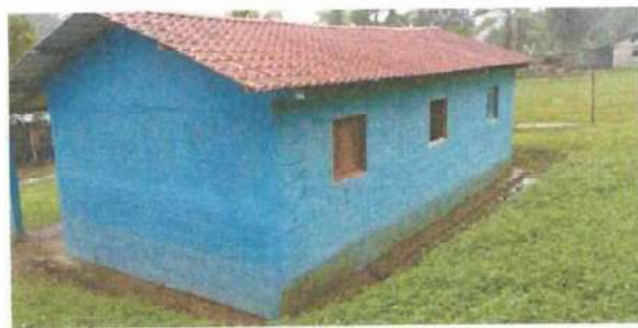
Foto 3: ENTECHADO DEL CENTRO EDUCATIVO PANDEADO POR LAS VIGAS DE MADERA DETERIODADO.
