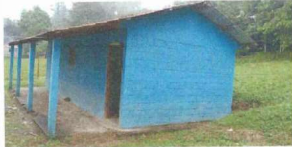
Foto 4: VISTA DEL CENTRO EDUCATIVO CON VENTAS Y PUERTAS DE MADERA CON NECESIDADES DE REMOZAR.
