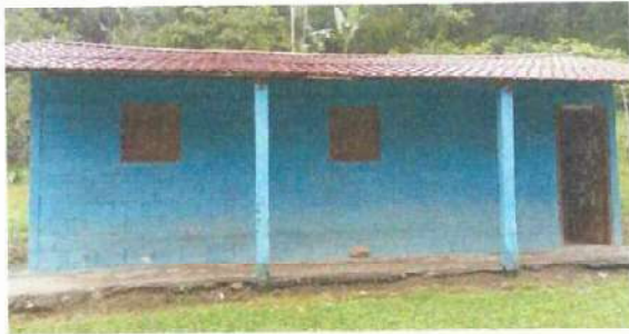
Foto 1: VISTA DEL CENTRO EDUCATIVO CON LAS NECESIDADES DE REMOZAR ENTECHADO Y CUBIERTA DE LAMINAS.
